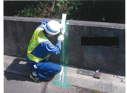
軟質ウレタン材等を遊間部に挿入。シール深さが一定になるように位置を決定し固定する。
