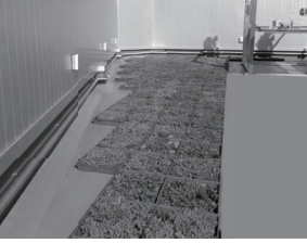
教育施設屋上 (VUS500)
